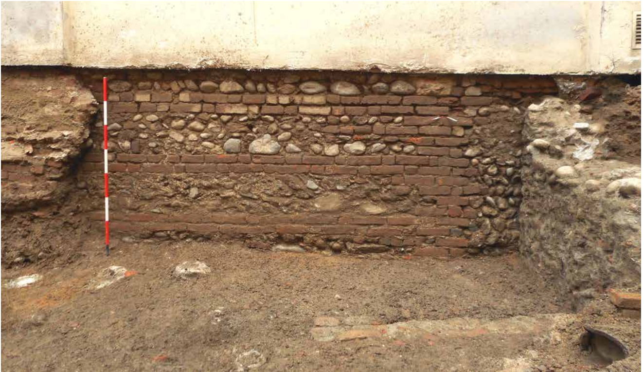
Fig. 63. Parete di edificio bassomedievale con estremità in mattoni predisposta per l'innesto di un nuovo setto murario (foto Studio Marco Subbrizio).
