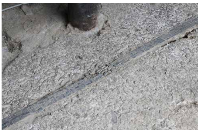
Fig. 73. Vano F. Fessurazioni e distacco di tessere lapidee della pavimentazione (foto D. Demonte - F. Di Iorio).
