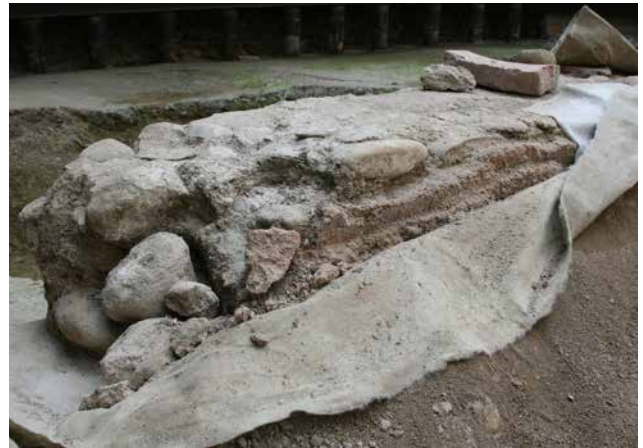
Fig. 72. Struttura muraria con distacco di frammenti di intonaco ed elementi lapidei, prima dell'intervento di restauro (foto D. Demonte - F. Di Iorio).
