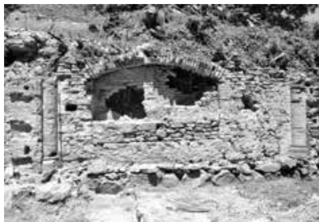
Fig. 50. Ceva. Parete nord della chiesa antica, settore del presbitero, inquadrato nell'elevato da due semicolonne con basi modanate lapidee, simmetriche a una nicchia tamponata (foto F.T. Studio s.r.l.).
